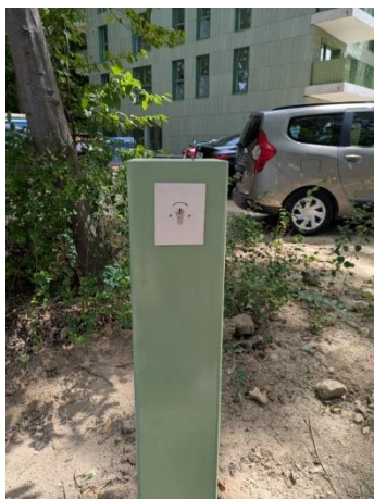
Paaltje met sleutelcontact voor het openen van de garagepoort bovenaan de inrit.
