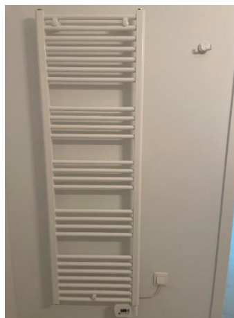
Elektrische radiator in badkamer
