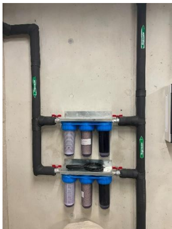
Filters voor regenwaterrecuperatie
