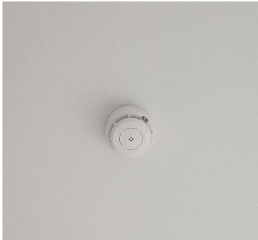
Rookmelder in het appartement
