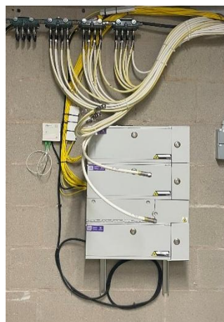
Technische installaties van Telenet en Proximus
