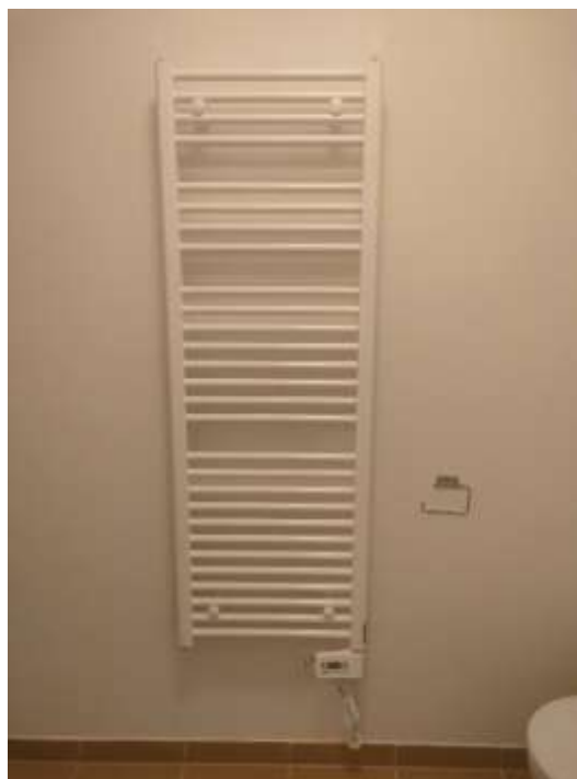
Elektrische radiator in badkamer
