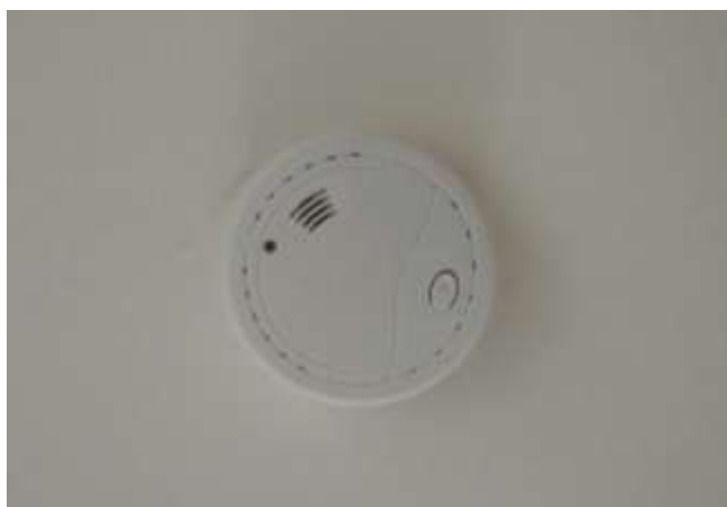
Rookmelder in het appartement
