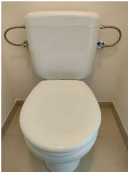
Toilet met dubbele aansluiting van regenwater en stadswater.
