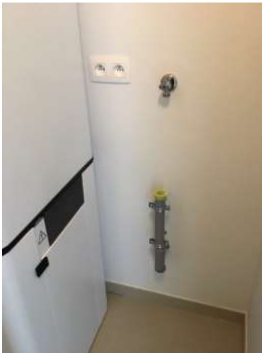
Aansluitpunt wasmachine en droogkast
