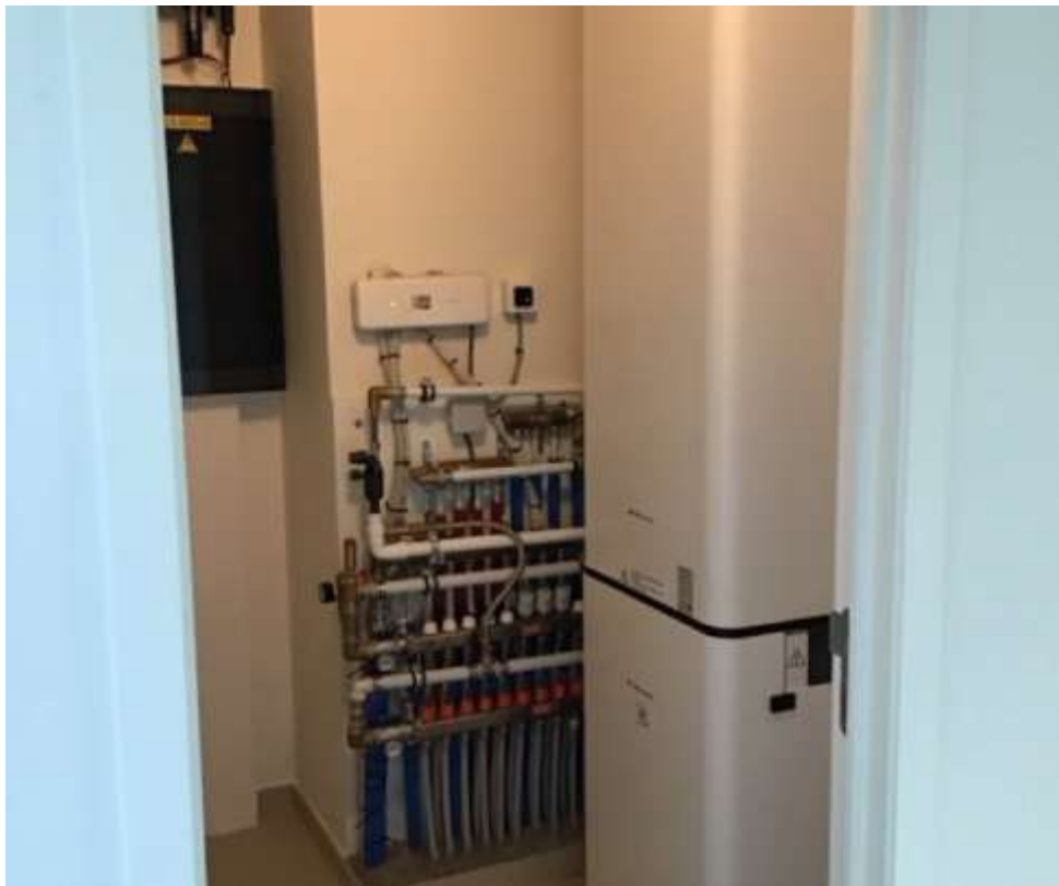
Collectoren met sturing en individuele geothermische warmtepomp
