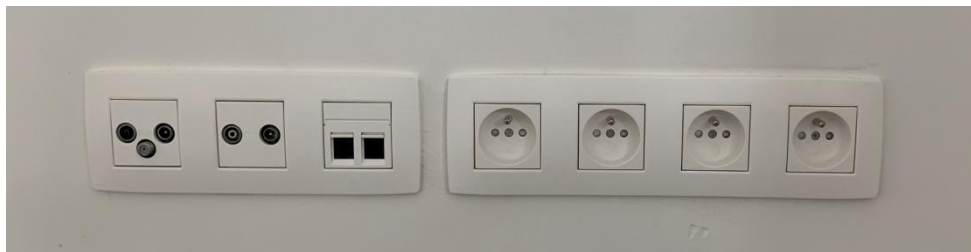
Aansluitingen, coax en upt (tv, telefoon en internet) in de leefruimte
