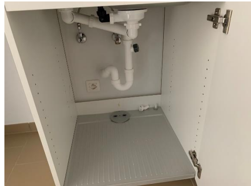
Aansluitingen voor de vaatwasser in de kast onder de spoelbak
