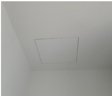
Toezichtluik in plafond
