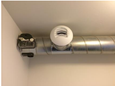
ventilatiemond en brandklep
