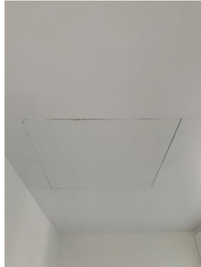
Toezichtluik in plafond
