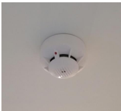
rookmelder in het appartement
