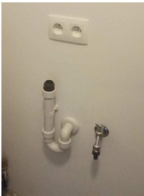
Aansluitpunt wasmachine en droogkast
