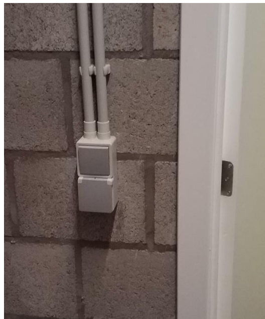
Individuele schakelaar en stopcontact
