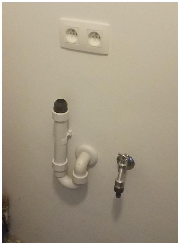
Aansluitpunt wasmachine en droogkast
