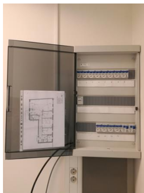
Zekeringsbord elektriciteit met elektrisch schema
