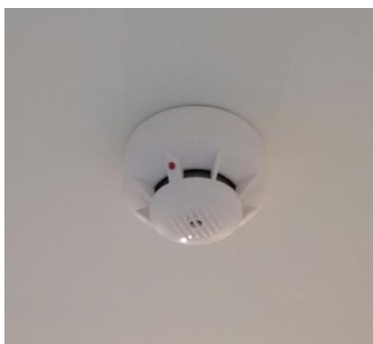
Rookmelder in het appartement
