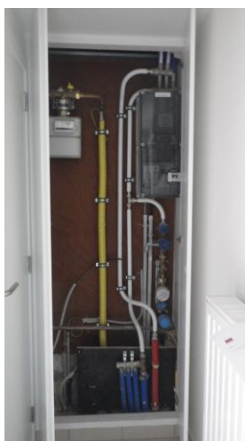
tellerkast naast toilet
