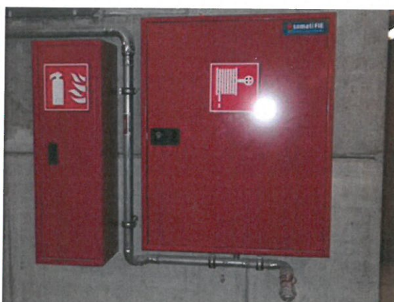
Brandblusser en brandslang in metalen kast
