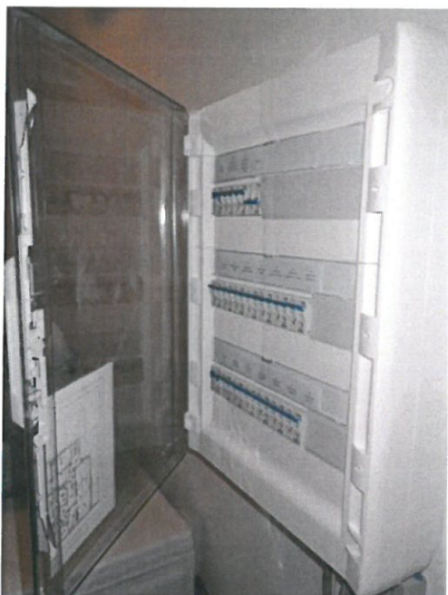
Zekeringsbord elektriciteit met elektrisch schema
