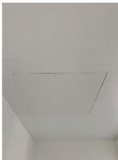
Toezichtluik in plafond
