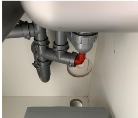
Aansluitingen afvoer en vaatwasmachine
