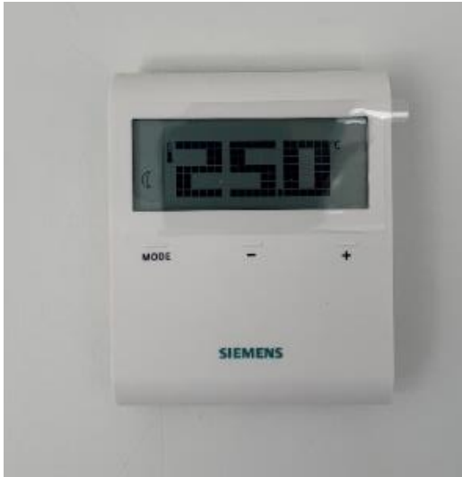
Kamerthermostaat type “Siemens”
