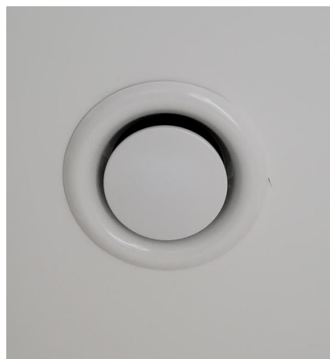
afvoerventiel vervuilde lucht
