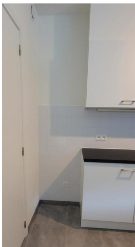
nis voor de plaatsing van de koelkast
