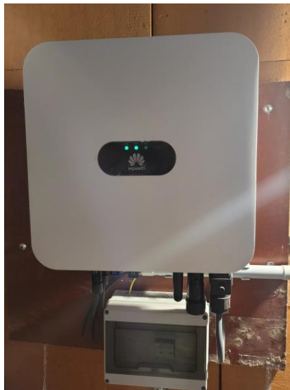
omvormer voor de zonnepanelen
