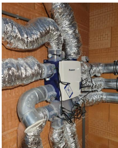
ventilatie-unit op de zolder
