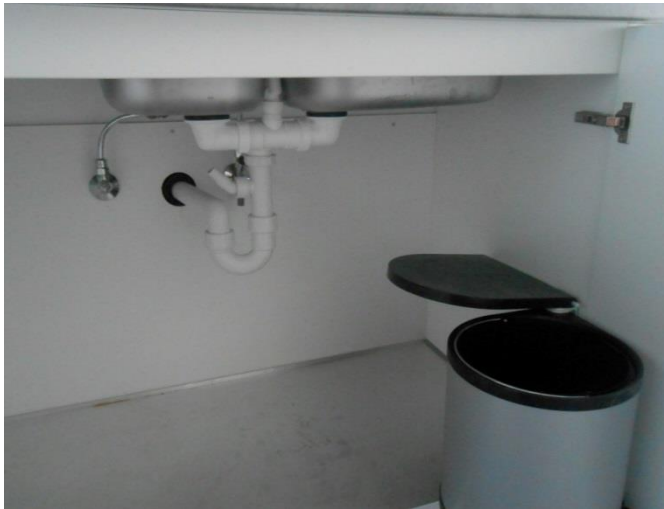
ruimte in keukenkast onder de spoelbak
