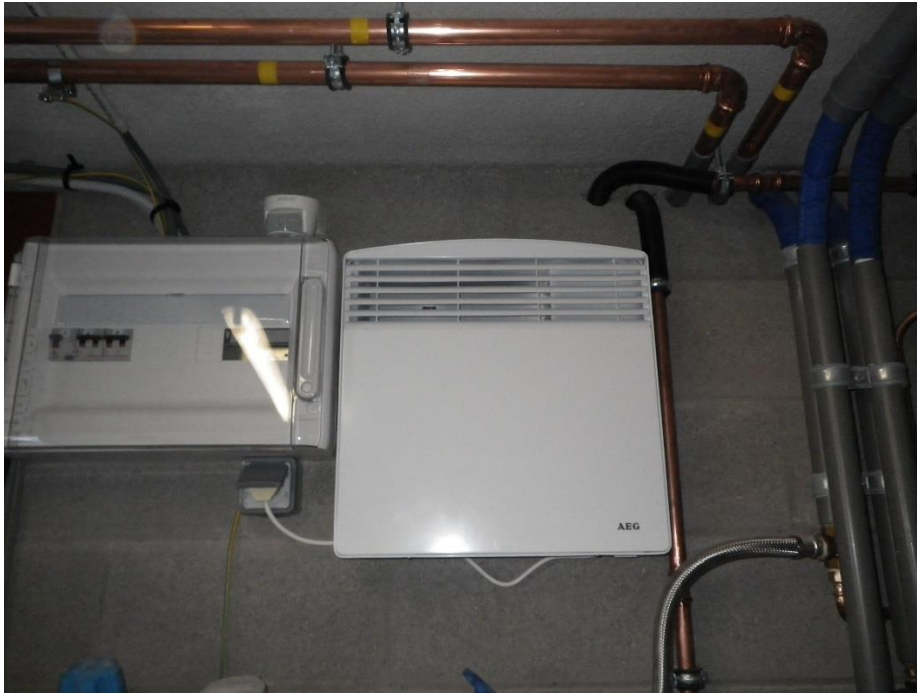
Verwarmingselement in de gemeenschappelijke kelderberging
