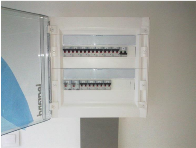
Zekeringsbord elektriciteit met elektrisch schema
