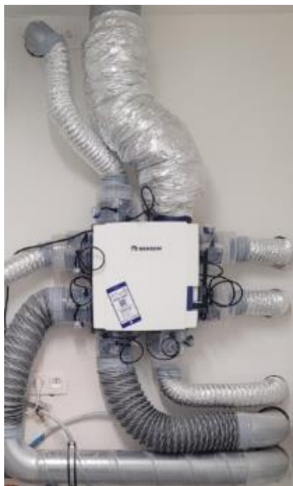
ventilatie-unit in de technische berging
